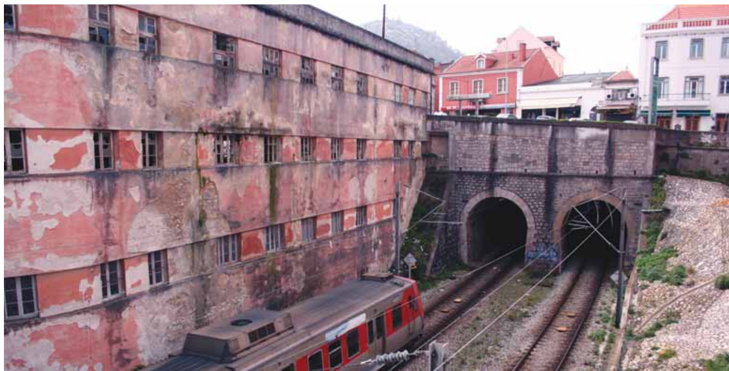
A antiga garagem Sintra vai receber obras urgentes para evitar o agravamento do estado de degradação do edifício
